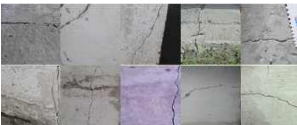
Рис.4: Фото з тріщинами.
