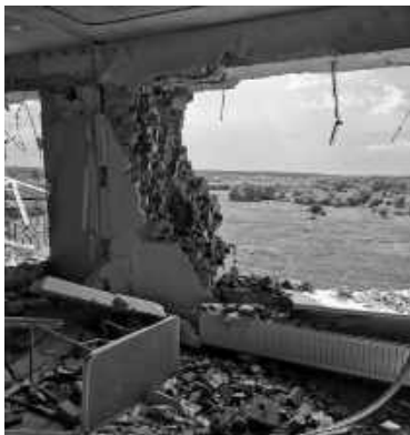
Рисунок.1 Часткове руйнування цегляного перестінку
