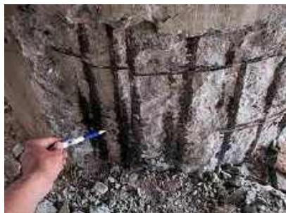
Рисунок 1. Бетонний контейнер системи зберігання - місця корозії арматури
